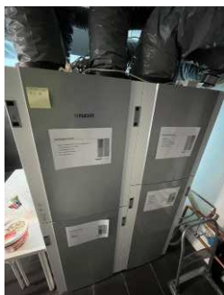
Ventilasjonsmodul plassert sammen med varmepumpe nede på teknisk rom
