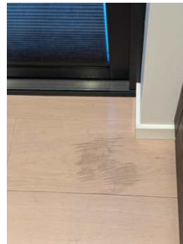
Merke i parkett ved terrassedør/kjøkken.
