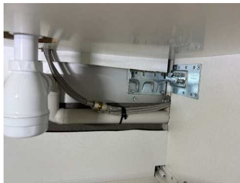
Røropplegg i servantskap
