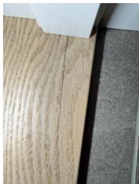
Sprekk i dørterskel til bad v/sov.
