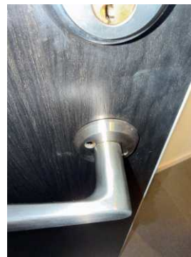
Manglende skrue i en entredør til vriderskilt.
