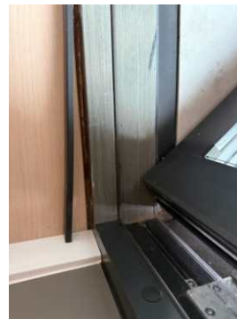
Det bemerkes en løsnet vaskelist ved balkongdør. (bør festes)
