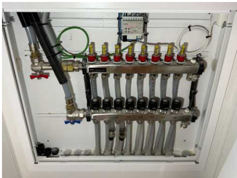
Rørskap for vannbåren varme
