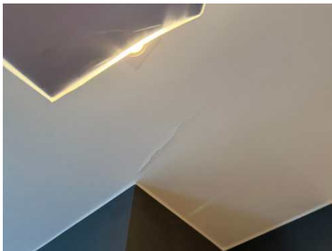
Riss/sprekk i tak ved peis
