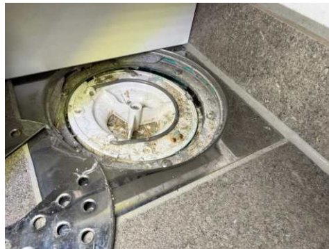
Sluk v/benkeskap på vaskerom
