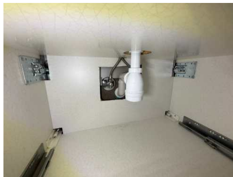
Rørøpplagg i servantskap
