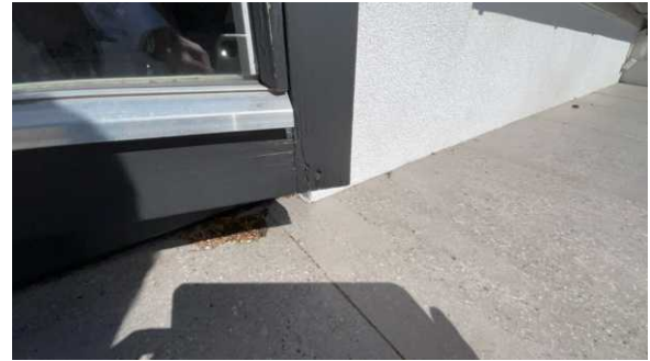
Avskalling i treverket.
