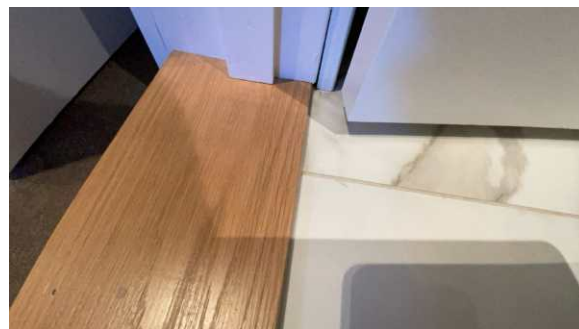
Luftespalte under dørbladet.
