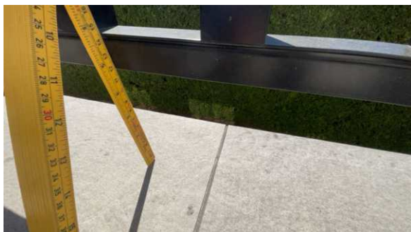
Åpning mellom gulv og rekkverk er mer enn 10cm.
