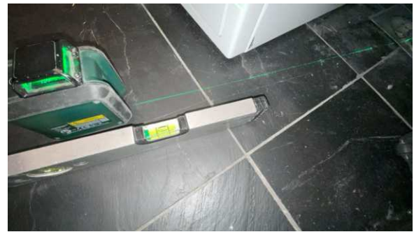
Motfall på baderomsgulvet i retning sluk.
