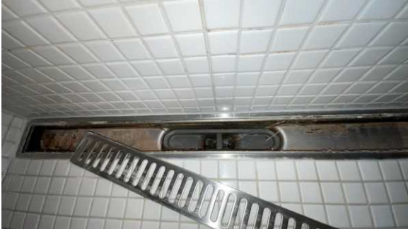
Slukrenne langs vegg i dusj.
