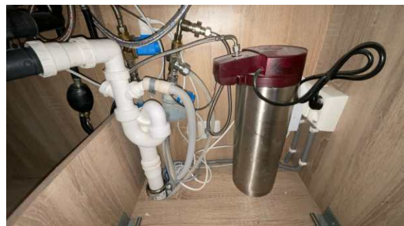
Røropplegg på kjøkken. Lekkasjestoppere.
