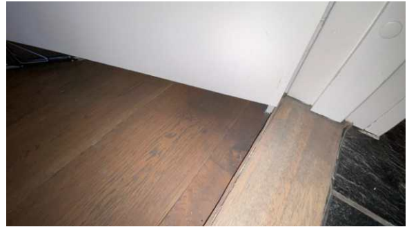
Luftespalte under dørbildet.
