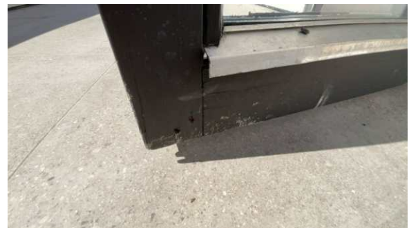
Avskalling i treverket.
