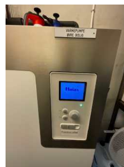
Varmepumpe for denne boligen.
