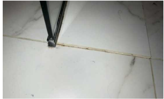
Sprekk i sementfuge som vist på bildet.
