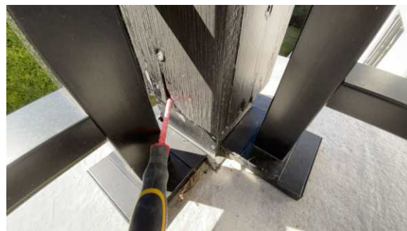
Noe malingsavskalling og sprekker i treverket.
