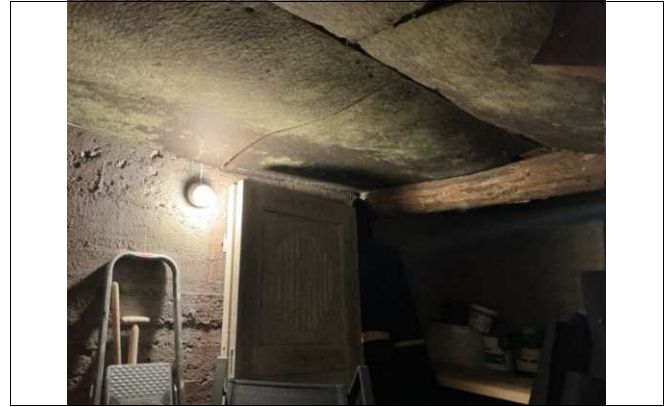
Eldre bjelker med asfaltplater, bør festes bedre, bjelker bør kontrolleres ytterligere
