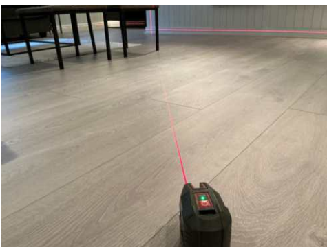
Nivellering kjellerstue, avvik ca. 10-20 mm
