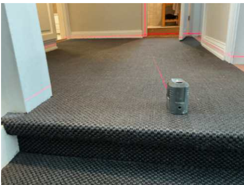
Nivellering trapperom 2 etasje, avvik ca. 10-20 mm
