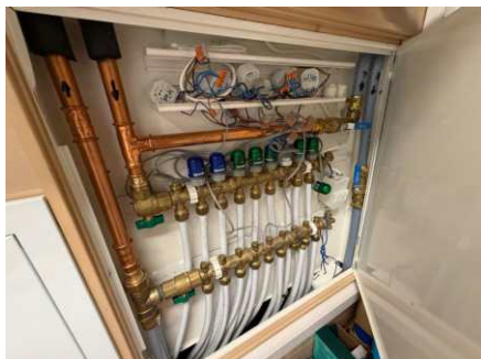
Rørskap til vannbåren gulvvarme.
