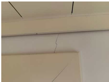
Sprukket flis over dør.
