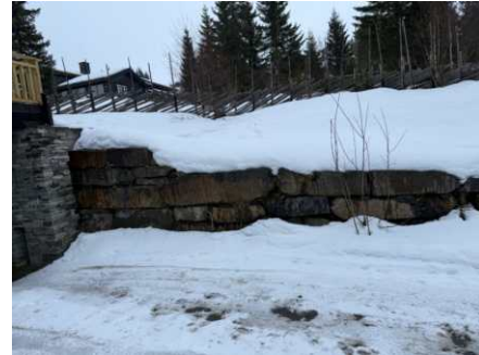
Manglende rekkverk på støttemur.
