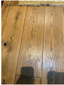
Tildels store tørkegliper mellom eikegulv.
