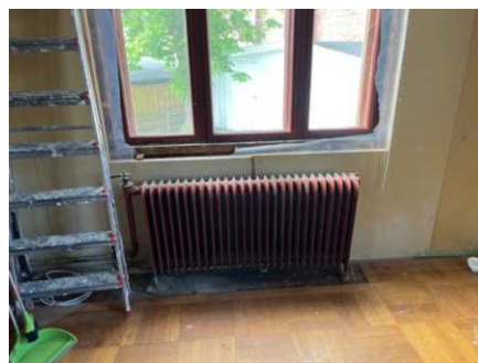
Radiatorer fra byggeår.
