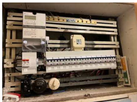
Sikringskap i 2 etasje.
