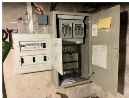
Sikringskap i kjeller.
