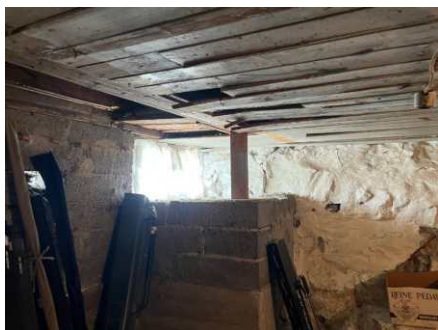
Avvik i kjeller/oppstøtting av bjelkelag.
