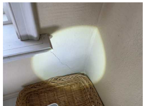
Eksempel på riss/sprekk i puss
