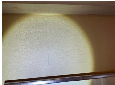
Stedvis mindre riss i murpuss
