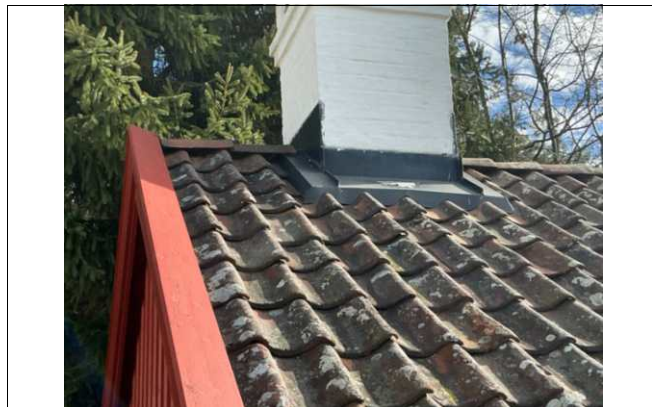
Slitasje/avskalling på beslag. Deler av pipe med murflater må jevnlig vedlikeholdes/impregneres for å begrense fuktoppsug
