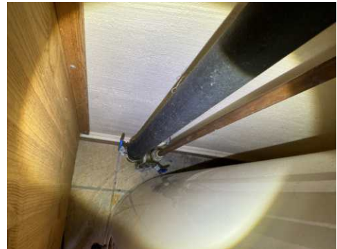
Stoppekran plassert bak bereder på vaskerom
