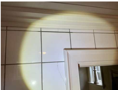
Sprekk ved dør og delvis løs flis
