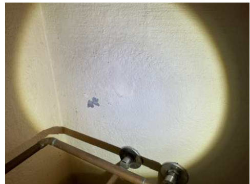
Saltutslag/luftblærer enkelte steder på yttervegg
