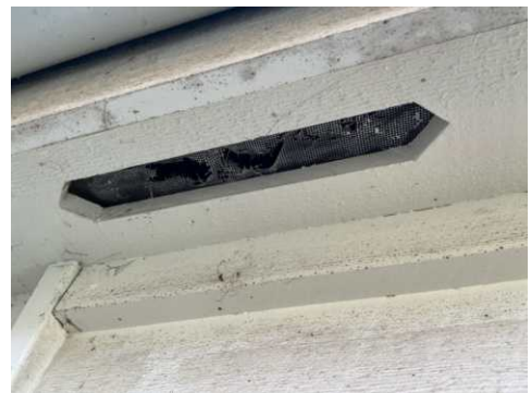
Fluenetting må byttes i enkelte spalter
