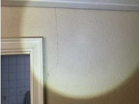
Eksempel på riss/sprekk i puss
