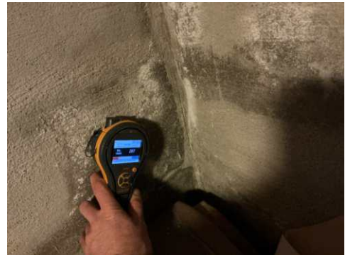
Saltutslag/fuktskjolder i hjørne av bodrom
