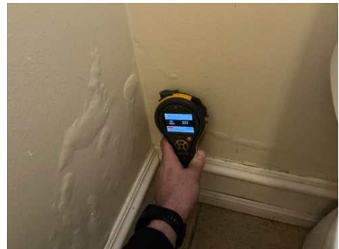
Saltutslag/luftblærer under maling ved toalett
