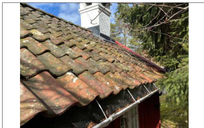
Nærme vegetasjon på bakside gir økt behov for vedlikehold
