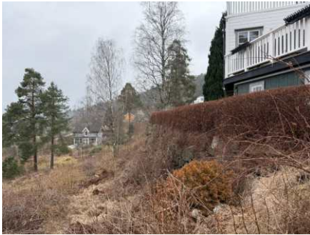
Støttemuren er tildekket med busker og ikke mulig å vurdere.
