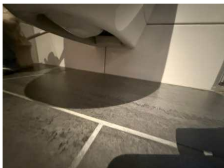
Ingen synlig dreneringsåpning under vegghengt toalett.
