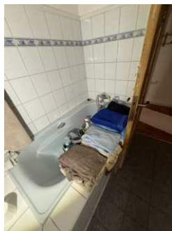
Ingen inspeksjonsluke til innunder badekar.
