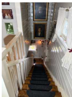
Rekkverk øvre del av trappen under 90 cm og det anbefales håndløper i trappeløpet.
