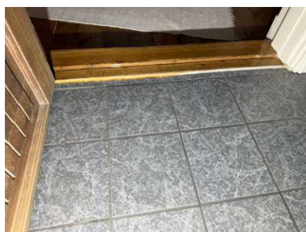
Ingen synlig membranoppkant ved dørterskel. Rommet er ikke lekkasjesikkert.
