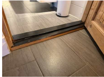
Ikke mulig å verifisere membranoppkant ved dørterskel uten fysiske inngrep.
