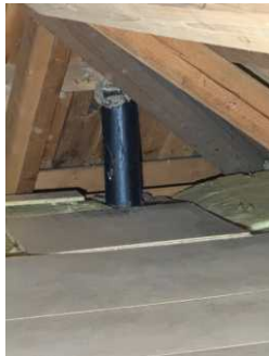
Lufting av kloakk anbefales være isolert på kaldtloft.
