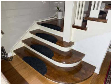
Noe knirk i nedre del av trappen.
