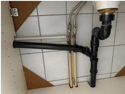
Eldre kobberledninger til bad i 2. etg. Naturlig å bytte ved oppgradering av våtrommet.
