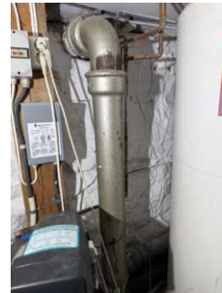
Eldre støpejernsrør observert i kjeller.
