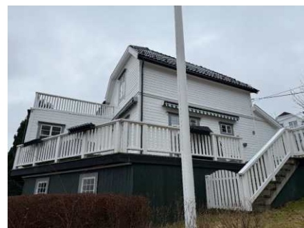
Rekkverkshøyder er under dagens krav på 1m
