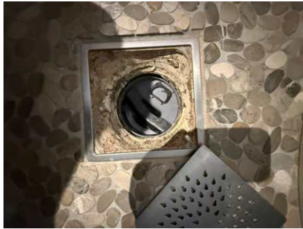
Synlig membranmansjett i sluk observert.
