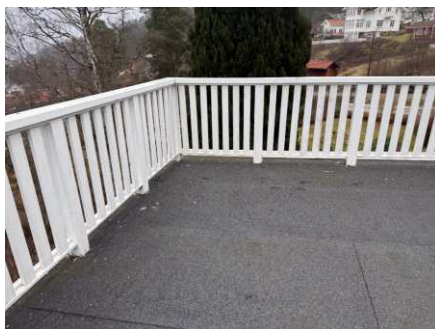
Noe vedlikeholdsbehov av rekkverk.
