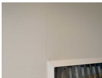
Risset over rørskapet i entréen.
