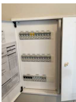
Sikringsskapet er plassert på vaskerommet.
