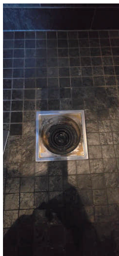
Sluk i dusjsone
