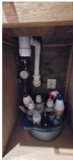
avstegning montert i skap på vaskerom
