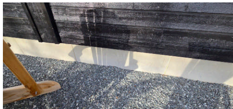
Riss i element
