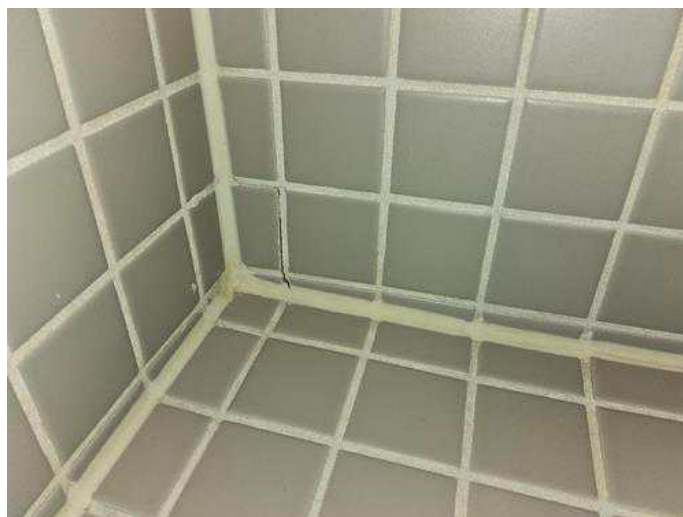
Overflater vegger - [Sprekk/riss flisfuge dusjsone]
