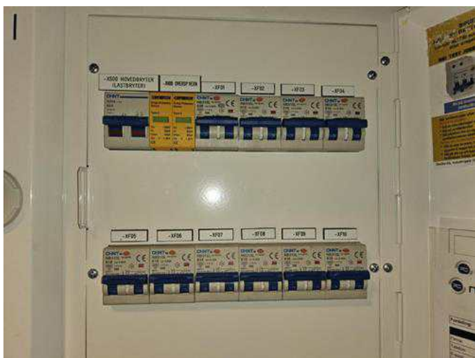
Elektrisk anlegg - [Sikringsskap ]
