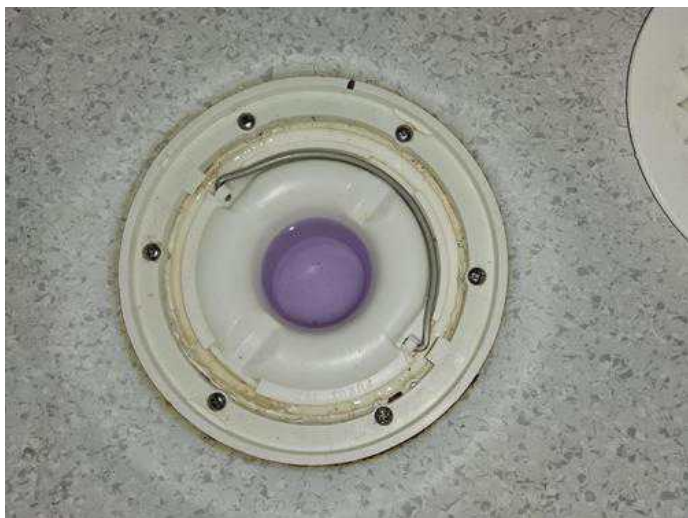
Avløpsrør (ink. sluk) - [Sluk vaskerom/teknisk bod]
