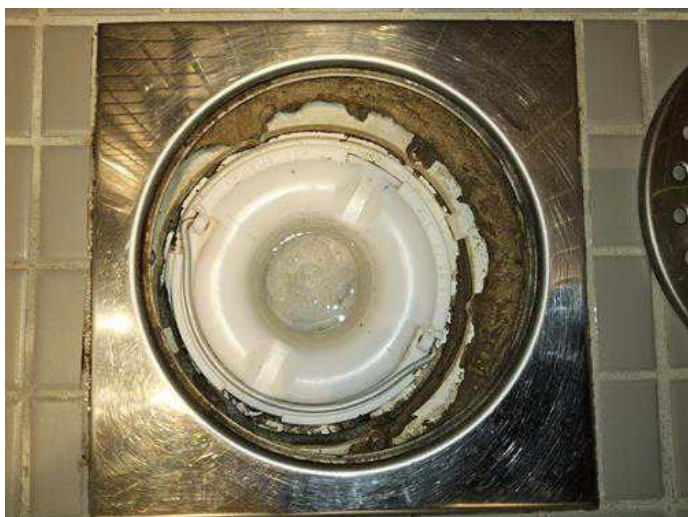
Avløpsrør (ink. sluk) - [Sluk bad]
