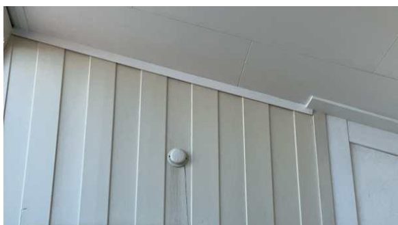
Eksempel på montert ventil i vegg.
