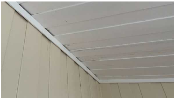
Spor etter vannlekkasje.
