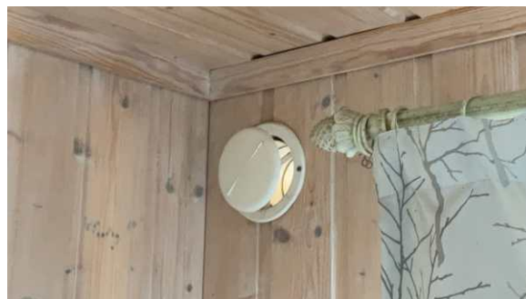
Eksempel på montert ventil i vegg.
