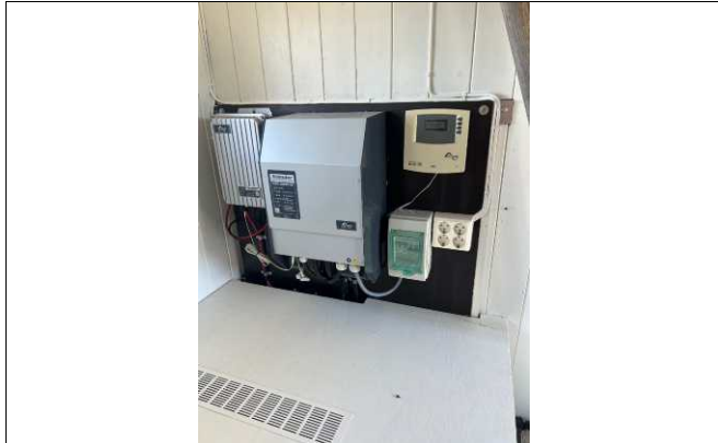
Styre panel til strøm opplegg.
