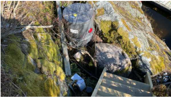
Tank for avløp.
