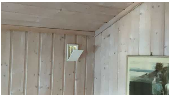
Eksempel på montert ventil i vegg.
