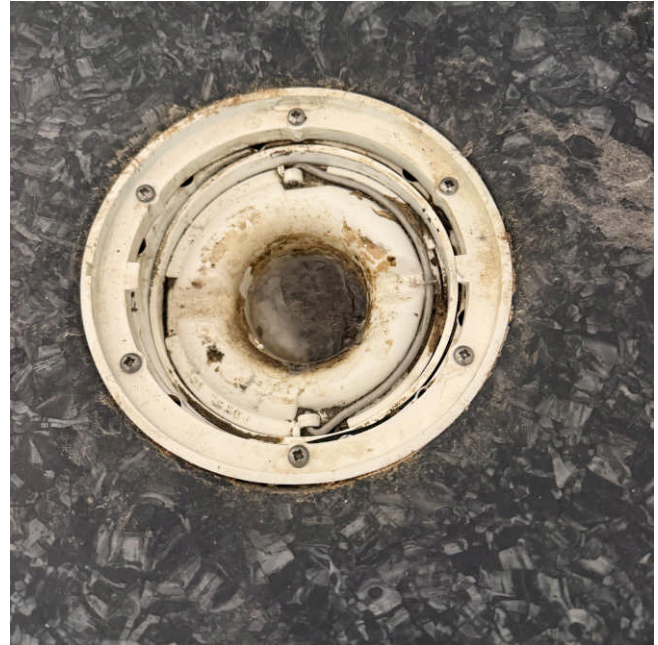
Sluk under dusjkabinett
