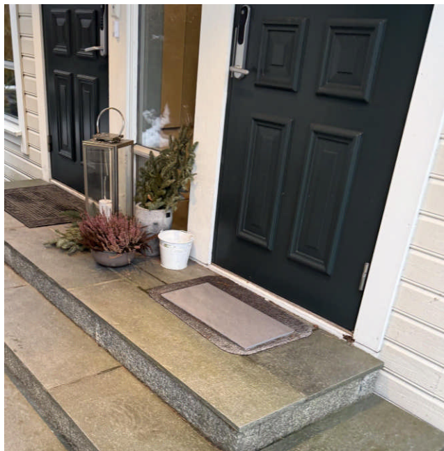
Manglende beslag og råte i bord under dør til vaskerom.
