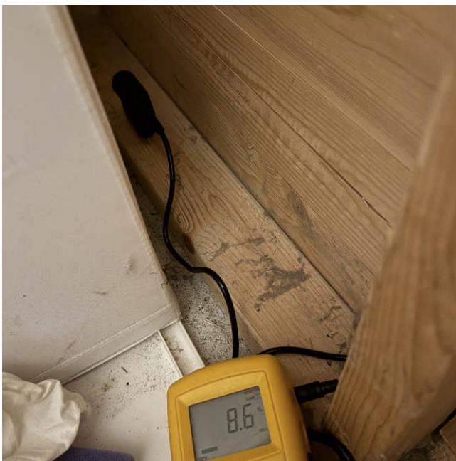
Fuktmåling i vegg bak dusjkabinett i skap i gang.
