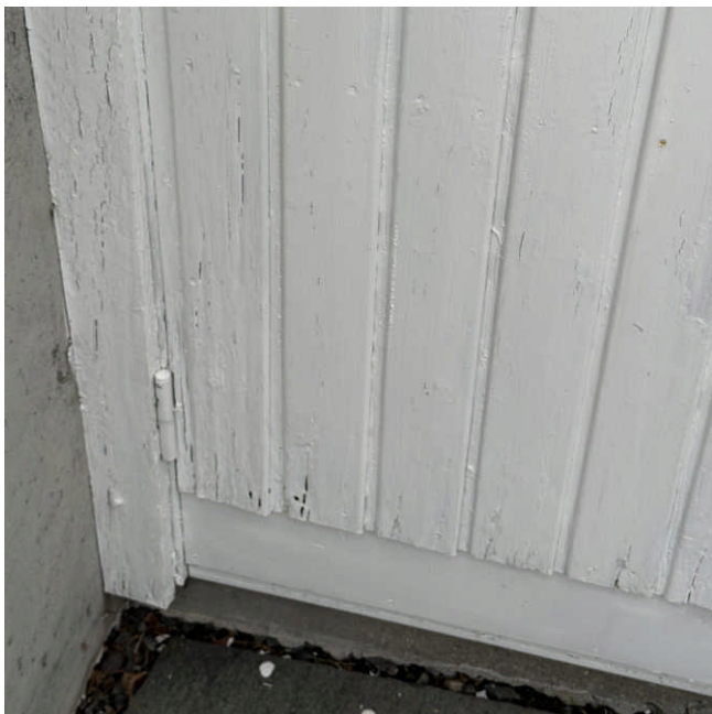
Råte i boddør til teknisk bod.
