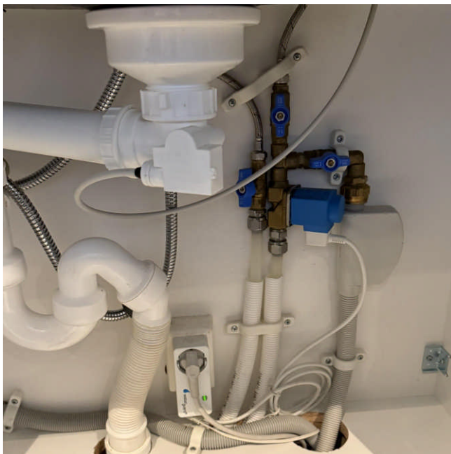
Rør i rør mangler muffe
