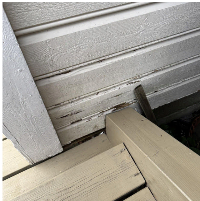
Råte i kledning teknisk bod
