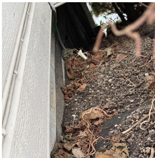
Mangler toppliste og terreng høyere enn grunnmursplate.
