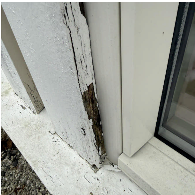
Råte i belistning
