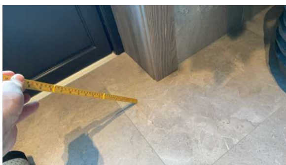
Bom/hulldyd på flis ved dør.
