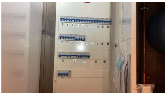
Sikringsskap plassert på teknisk rom.
