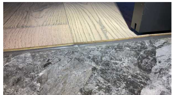
Ingen oppbrett av membran ved terskel.
