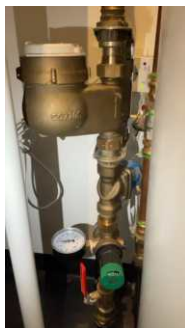
Hovedstoppekran, vannmåler og reduksjonsventil.
