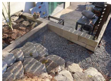
Forstøtningsmur uten rekkverk
