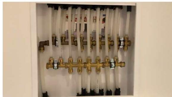
Fordelerskap med rør i rør opplegg.
