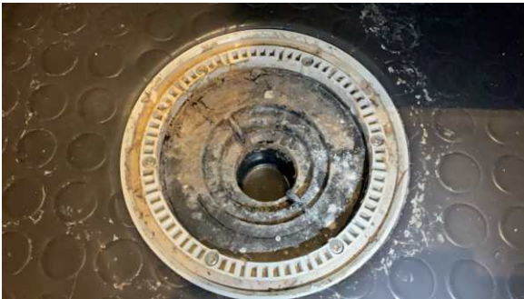
Plastsluk ved bereder.
