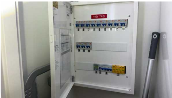
Sikringskap med automatsikringer.
