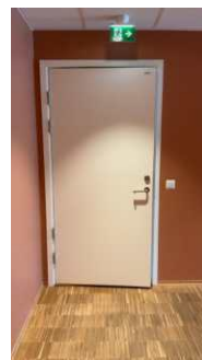
Lyd og branndør inn til leiligheten
