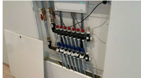
Fordelingsskap i hallen.
