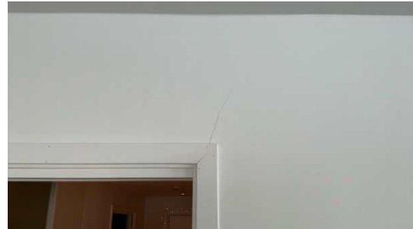
Riss i veggen ved døra mellom hallen og stuen
