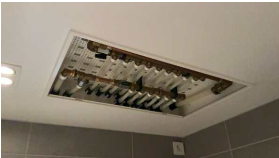
Rørskapet er plassert i taket på badet.
