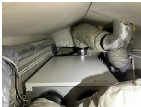
Sentral for ventilasjon plassert på loft.
