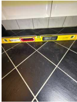
Motfall under servant mot yttervegg.
