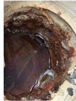
Rust i eldre sluk under badekar.
