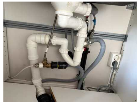
Ingen synlig lekkasjesikring.
