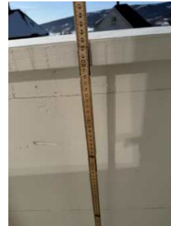
Rekkverk lavere enn dagens krav.
