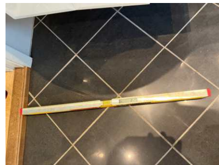
Ingen til lite fall mot sluk på gulv utenfor dusjsonen.
