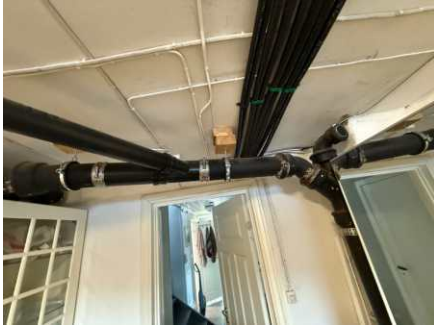
Avløp av soil og plast.
