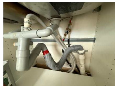
Ingen synlig lekkasjesikring.
