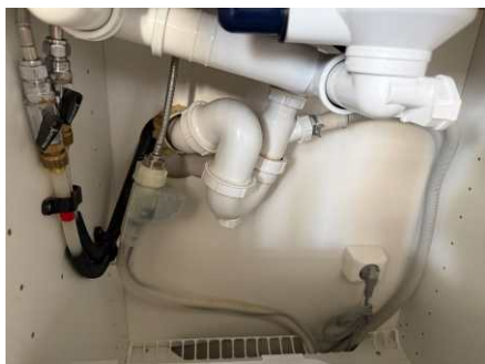
Ingen synlig lekkasjesikring.
