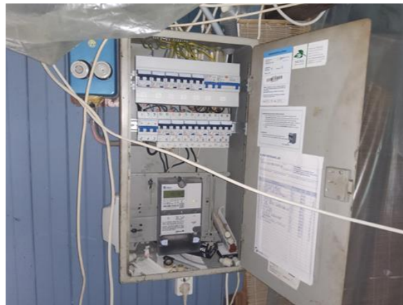
Elektrisk anlegg - [Sikringskap]
