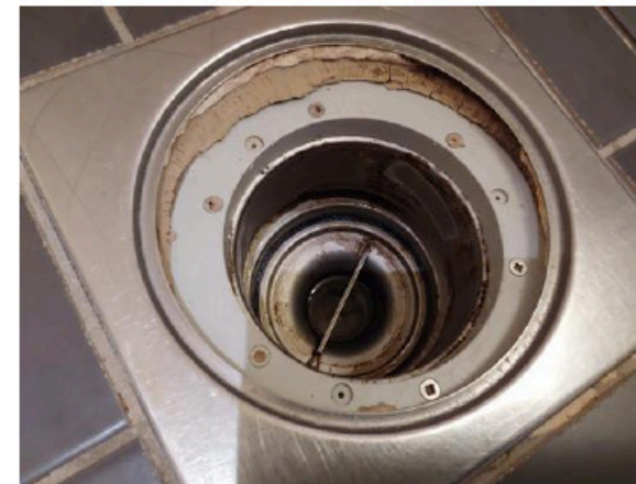
Avløpsrør (ink. sluk) - [Sluk bad]
