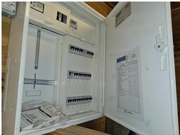
Elektrisk anlegg - [Sikringsskap]
