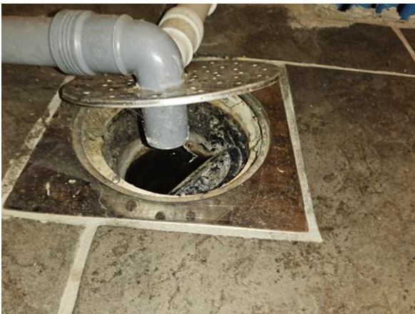
Avløpsrør (ink. sluk) - [Sluk vaskerom.]
