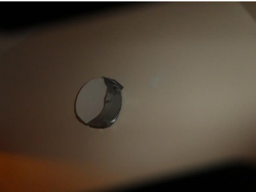
Veggventil som er tettet med tape
