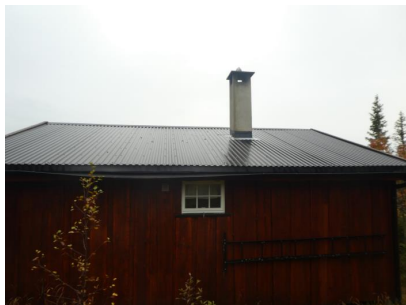
Deformasjoner i takrenner samt manglende snøfangere
