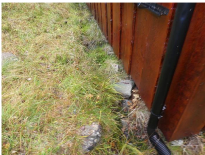
Feil fallforhold på øversiden av hytte
