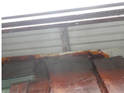
Manglende gesimsbord og undertak
