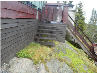
Trapp uten rekkverk
