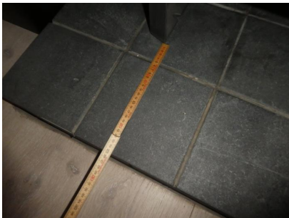
Mindre enn 30 cm til brennbart foran vedovn
