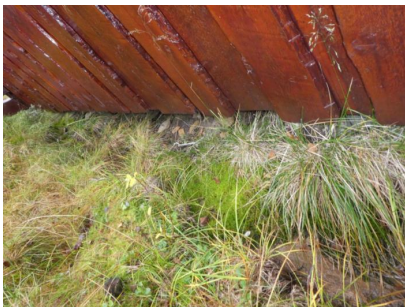
Stående vann på øversiden av hytte
