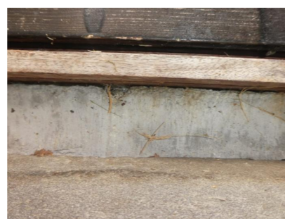
Ikke montert beslag under dør
