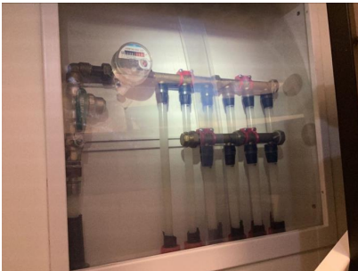
Fordelerskap med vannmåler og hovedstoppekran plassert i bod.
