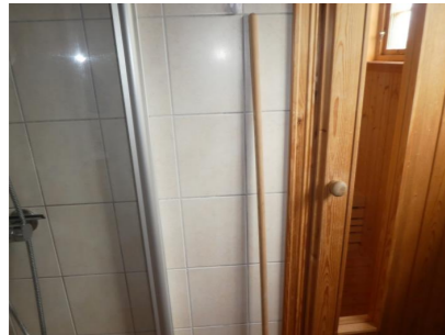
Dør nærmere enn 1 m fra dusjsone
