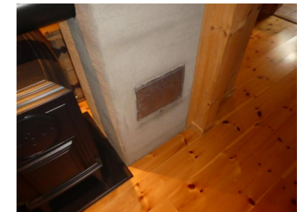
Ingen plate på gulv under sotluke
