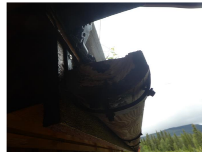
Lekkasje i enden av takrenne
