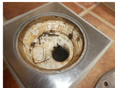
Sluk i dusjsone
