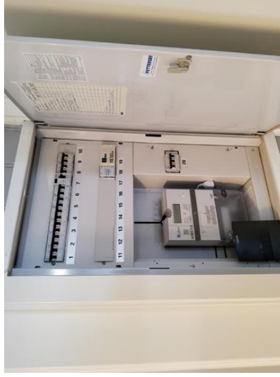
Elektrisk anlegg - [Sikringsskap]
