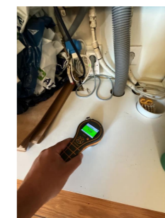
Svelling i bunplate. Fuktsøk ok.
