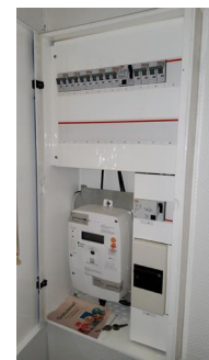
Elektrisk onlegg - [Sikringskap]
