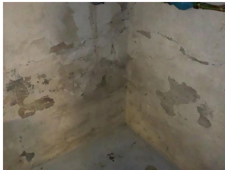
Forhøyede fuktverdier mot grunnen er registrert, se "rom under terreng".
