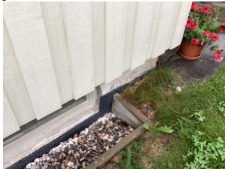
Grunnmursplast mangler avslutningslist over terreng, dette må monteres slik at vann ikke renner ned på innside av grunnmursplast.
