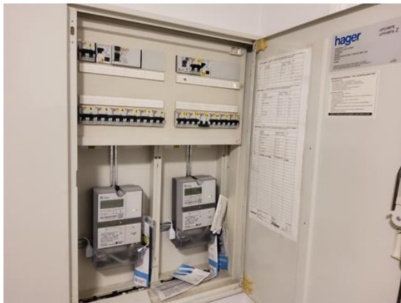
Elektrisk anlegg - [Sikringsskap]
