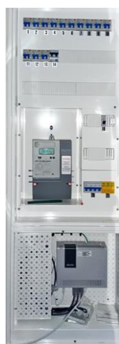
Forenklet vurdering av det elektriske anlegget - [Sikringsskap underetasje]
