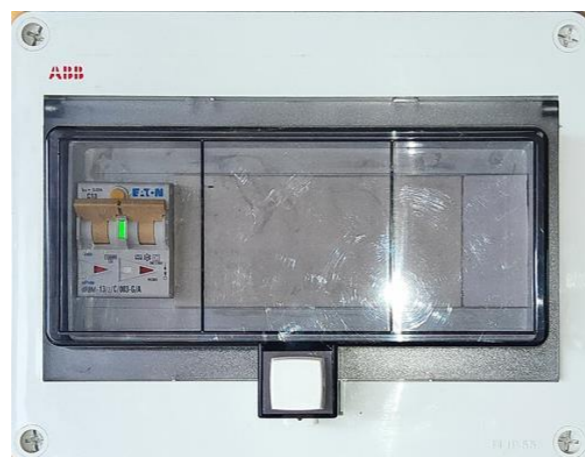
Forenklet vurdering av det elektriske anlegget - [Sikringsskap garasje]
