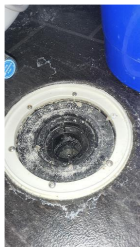
Avløpsrør (ink. sluk) - [Sluk vaskerom underetasje]
