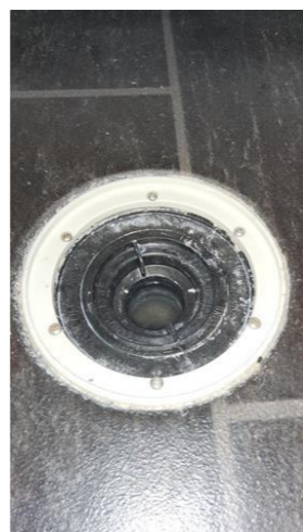
Avløpsrør (ink. sluk) - [Sluk vaskerom 1. etasje]
