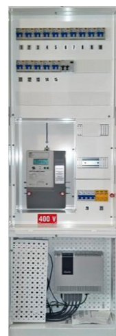
Forenklet vurdering av det elektriske anlegget - [Sikringsskap 1. etasje]
