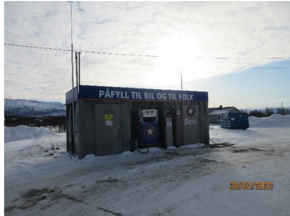
Pumpeanlegg for diesel og bensin
