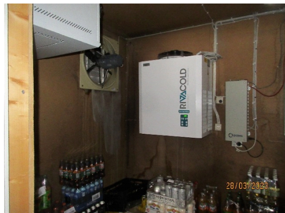
Kjølerom / teknisk rom
