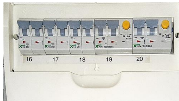
Forenklet vurdering av det elektriske anlegget - [Sikringskap]
