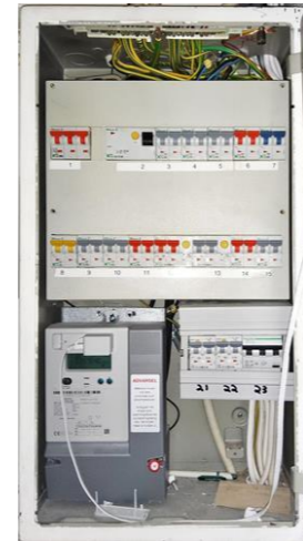
Forenklet vurdering av det elektriske anlegget - [Sikringskap hoveddel]
