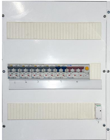
Forenklet vurdering av det elektriske anlegget - [Sikringskap garasje]
