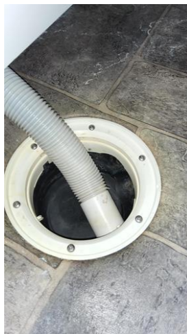
Avløpsrør (ink. sluk) - [Sluk bad hoveddel]
