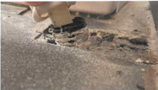
Rørgjennomføring uten membranmansjett
