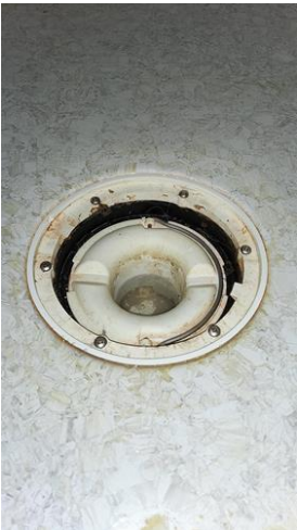
Avløpsrør (ink. sluk) - [Sluk 2 bad loftsetasje]
