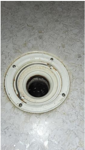
Avløpsrør (ink. sluk) - [Sluk 1 bad loftsetasje]
