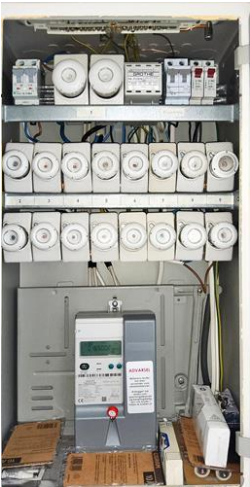
Forenklet vurdering av det elektriske anlegget - [Sikringsskap]
