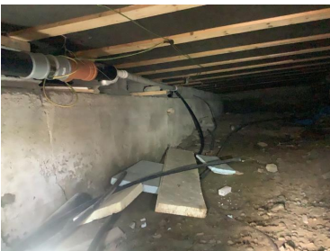
Manglende lufting av konstruksjonene. Sprekk i ringmuren.
