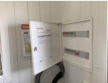
El-anlegg med automatsikringer. Åpent og skjult ledningsnett. Sikringsskapet er plassert i entre.
