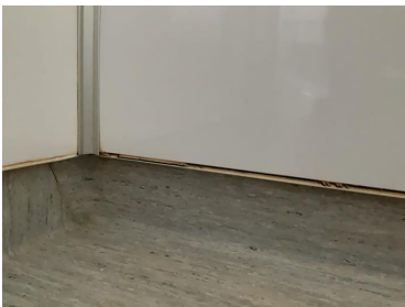
Sprekker i tettesjikt/fuge under baderomsplater. Tiltak må gjøres så det ikke oppstår fuktskader i baderomsplater.
