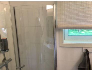
Vindu er plassert i våtsonen.
