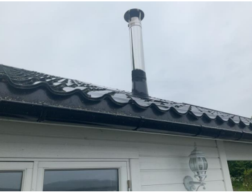
Ufagmessige arbeider på piperør over tak.
