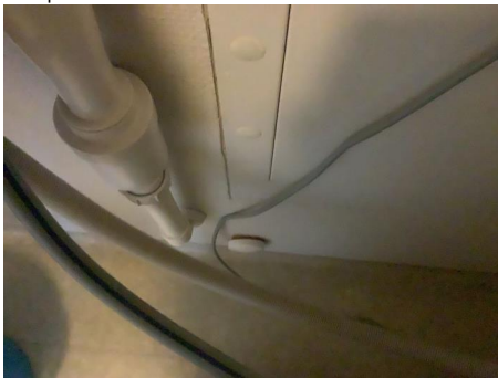
Avrenning fra fordelerskap.
