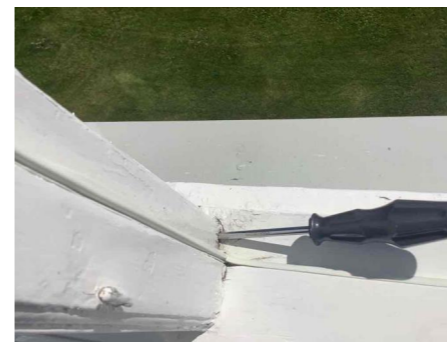
Råteskadet vindu registrert. Nevnte forhold gis tilstandsgrad 3.
