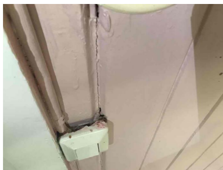
Ødelagt deksel på lysbryter registrert.
