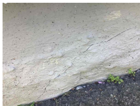
Sprekker i grunnmur registrert.
