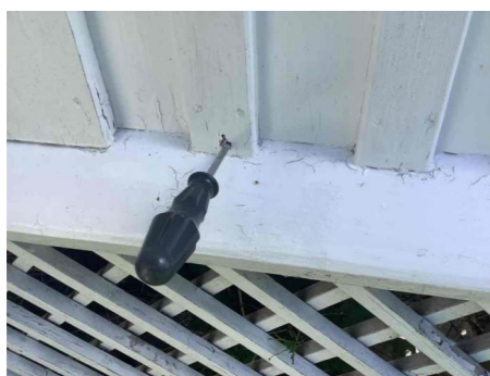
Råteskader observert på kledning enkelte steder.
