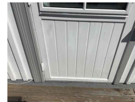
Altandør bærer preg av slitasje. Utett mellom dørterskel og tekking.
