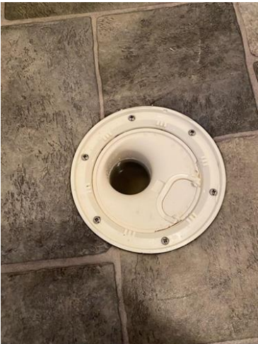
Avløpsrør (ink. sluk) - [Sluk bad]
