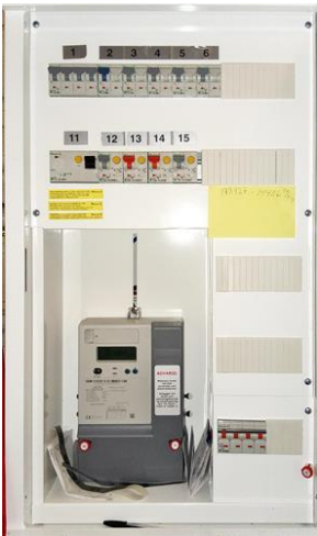
Forenklet vurdering av det elektriske anlegget - [Sikringsskap]
