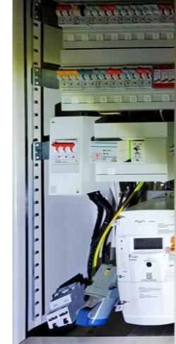
Forenklet vurdering av det elektriske anlegget - [Sikringskapp]
