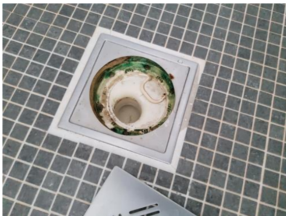
Avløpsrør (ink. sluk) - [Sluk bad 1. etg]
