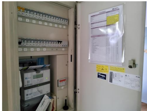
Elektrisk anlegg - [Sikringskap]
