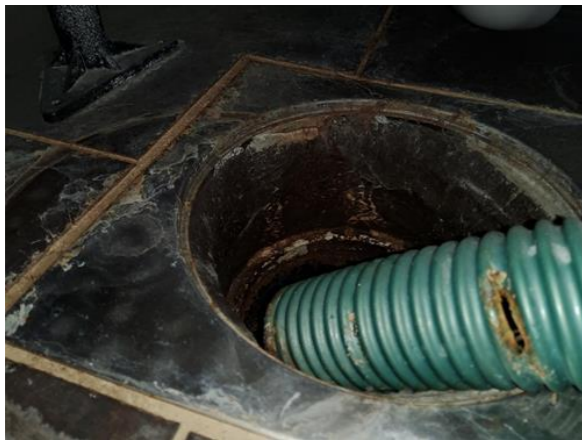
Avløpsrør (ink. sluk) - [Sluk bad 2. etg]
