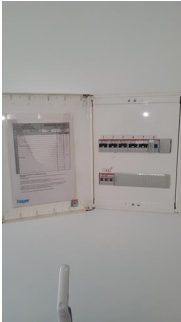
Elektrisk anlegg - [Sikringskap]
