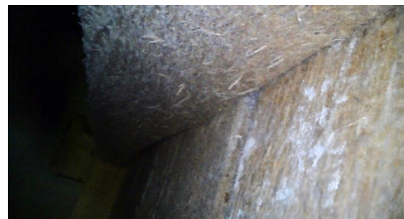
Mugg som følge av fuktighet i krypkjeller
