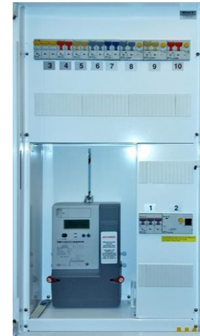
Forenklet vurdering av det elektriske anlegget - [Sikringskapp]
