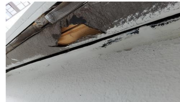
Fasader ink. kledning - [Skade på vindsperre]
