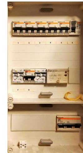
Forenklet vurdering av det elektriske anlegget - [Sikringskap]
