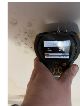
Fuktsøk viser unormale verdier i på undersiden av etasjeskiller under badet.
