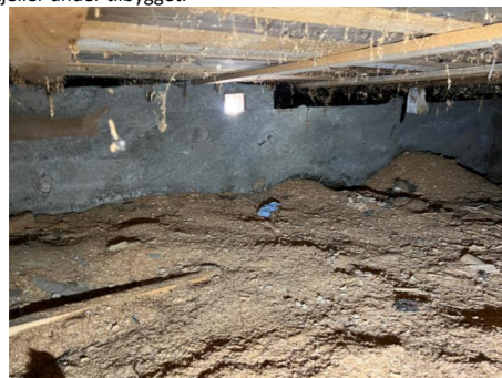
Krypkjeller under tilbygget. Sagflis på grunnen.
