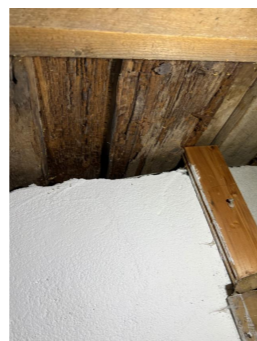
Råteskader i stubbloft på undersiden av etasjeskille.
