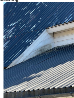
Eksempel på råteskadet kledning.
