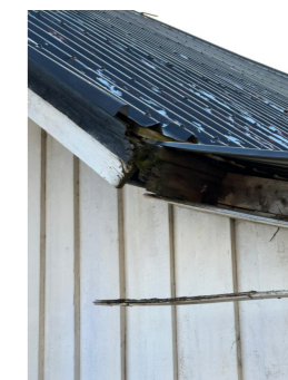
Råteskader i takkonstruksjon.
