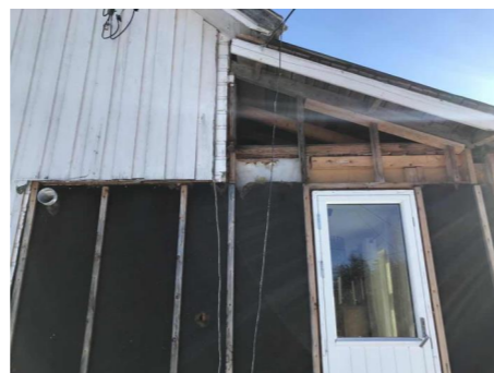
Eksempel på åpninger i utvendig komplettering og ikke ferdigstilte komplettering.
