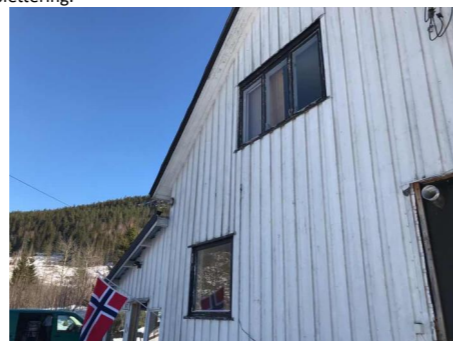
Eksempel på slitt kledning
