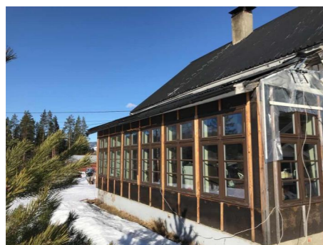
Eksempel på avvik på beslag, renner og nedløp.
