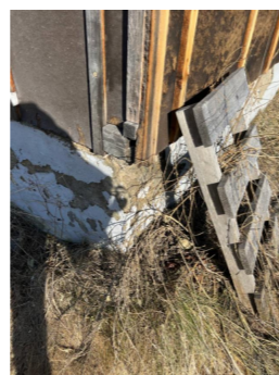
Eksempel på utvendig avskalling på grunnmur.
