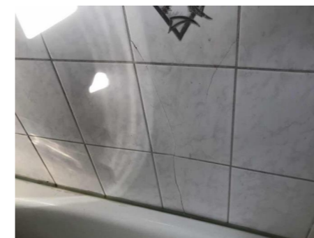
Sprekker i veggfliser i våtzone.
