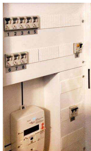
Forenklet vurdering av det elektriske anlegget - [Sikringskap]
