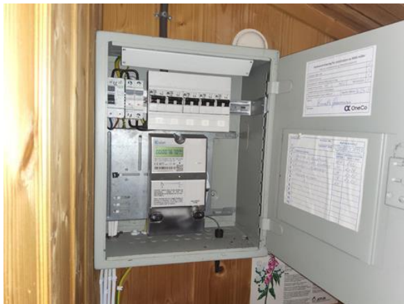
Elektrisk anlegg - [Sikringskap på toalett]
