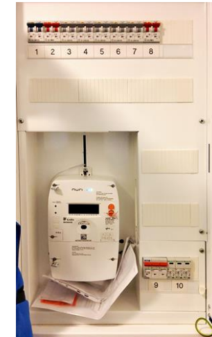
Forenklet vurdering av det elektriske anlegget - [Sikringskap i gang.]
